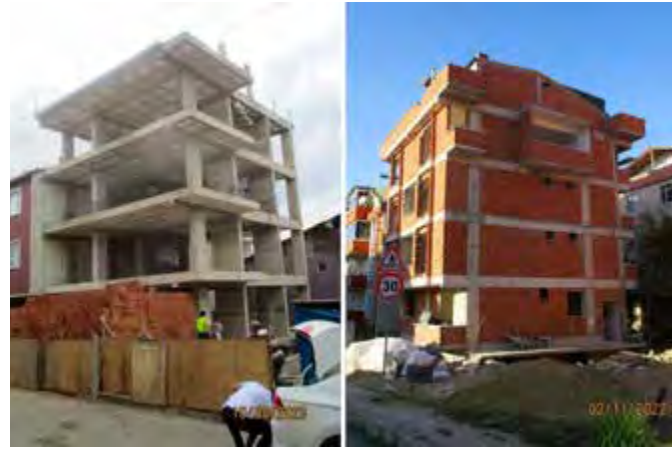
(%60 Seviye Kontrolü Örnek Fotoğrafı)
